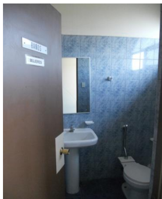
Ilustración 6: Baño de mujeres en zona de oficinas, 6ª Comisaría de San Vicente de Tagua Tagua.
